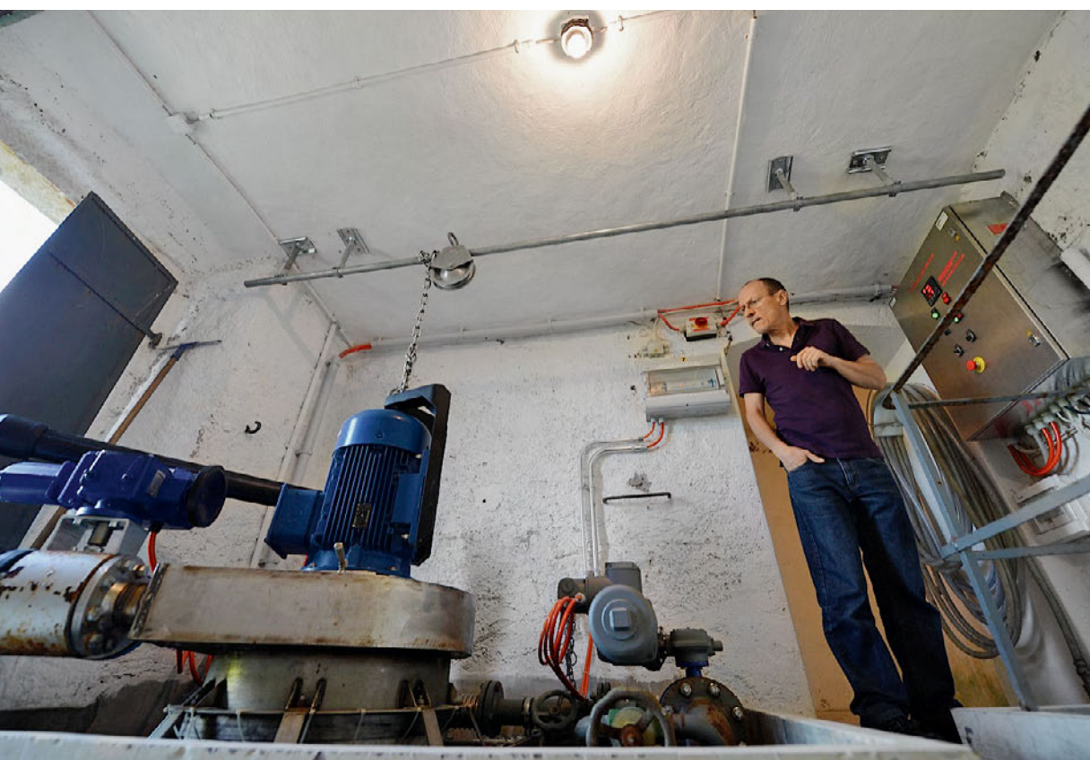
La microturbina azzurra ha una potenza di 6,5 kW. A destra si vede il quadro di comando.
