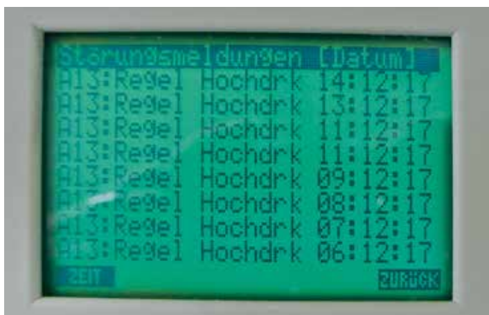
Illustration 6.5: Message d'erreur de la pompe à chaleur eau-eau. (Photo: Böhler, MTU GmbH)
