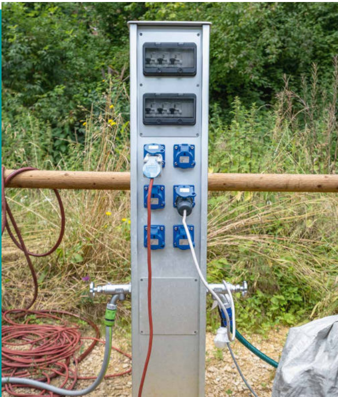
23 | Point d'alimentation en électricité et eau avec 3 prises par places de stationnement sur l'aire de passage de Wittinsburg, BL
